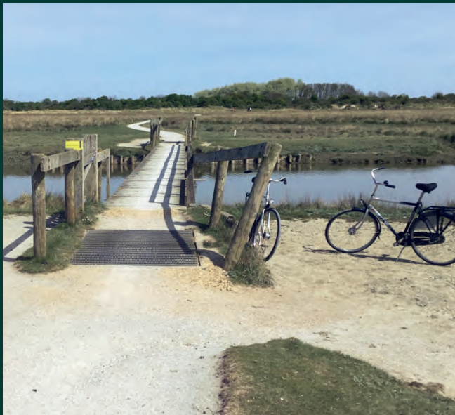
Afbeelding 5 Brug met herstelde uitspoeling
